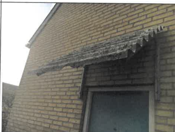
Eksempel på kraftigt medtaget baldakin, både med afskalninger, flosset kant og tegn på kraftigt nedbrud.
