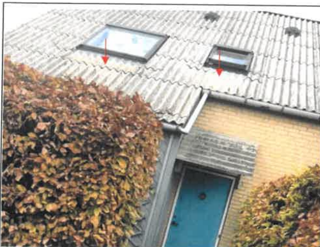
Eksempel på særlig hård slitage på tagplader under vinduer
