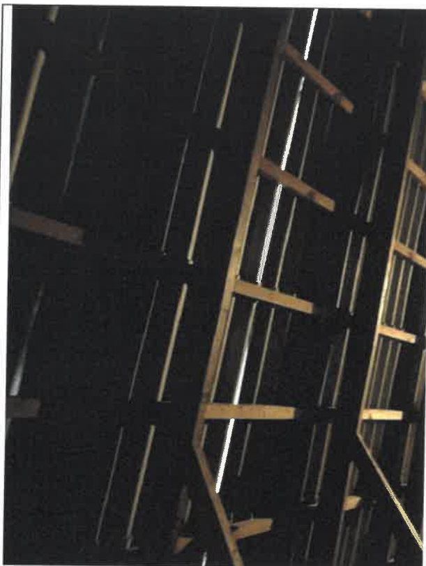
Eksempel fra etageboligernes loftrum. Tagplader lapper ikke længere over hinanden.
