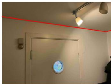
Føringsvej i loftkant
